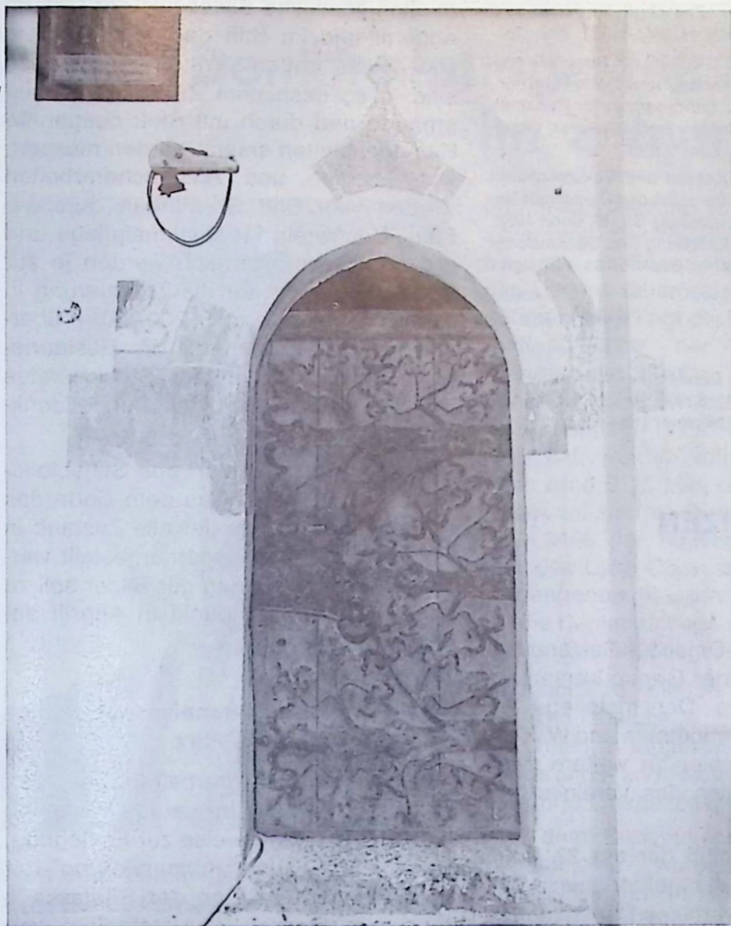
Abb. 12: Gebertsham, Filial- kirche, Sakristei- portal mit spätgoti- schen Beschlägen. Die Freilegungs- probe der gequa- derten, ocker Archi- tektureinfassung mit weißem Fugen- strich und schwarzem Begleitstrich zeigt die ursprüng- lich beabsichtigte Vollendung der gebauten Archi- tektur durch die Bemalung.
