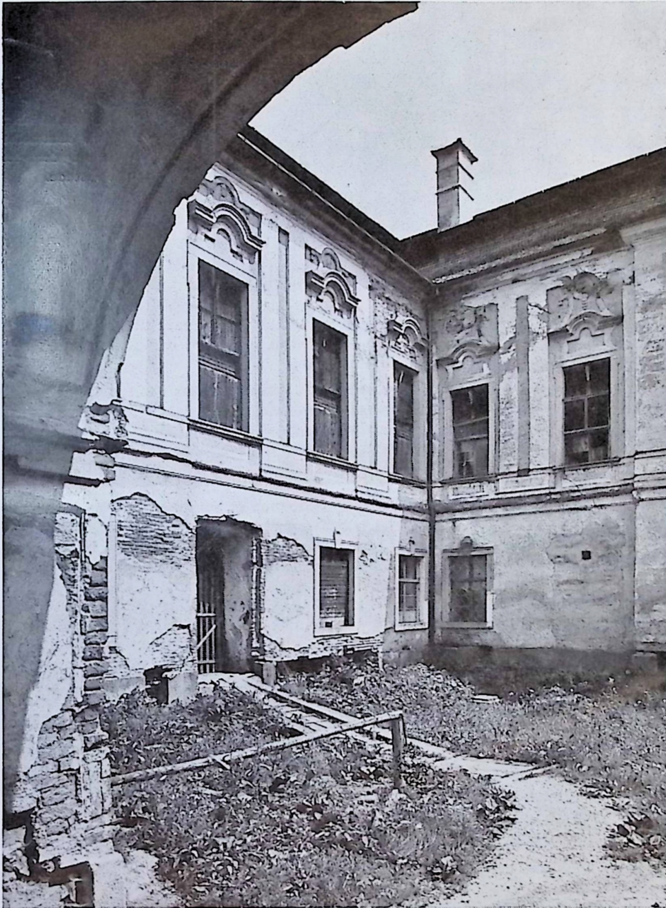
Jagdschloß Hohenbrunn, Innenhof, ruinöser Zustand vor Beginn der Renovierungsarbeiten. Die Baufälligkeit ist auf dem Bilde augenscheinlich.
