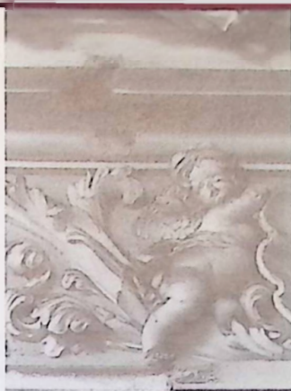
Ausschnitt aus dem Stuckfries im Langhaus: Verschmutzungen und Beschädigungen
